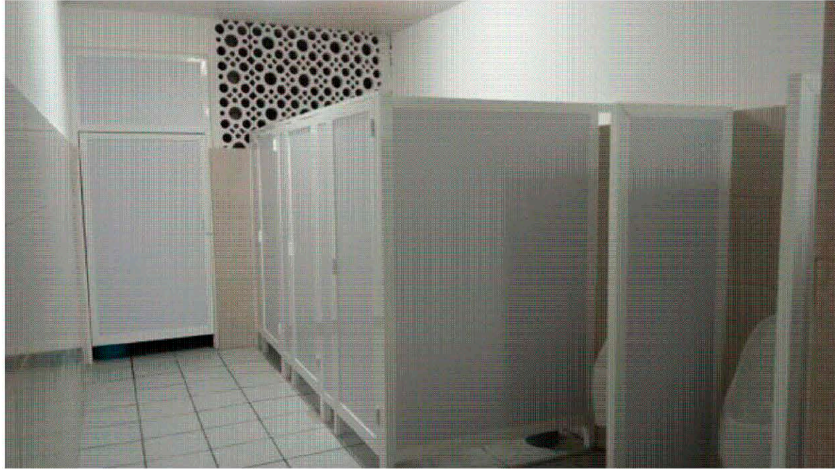
MAMPARAS DE ALUMINIO Y ACRILICO PARA DIVISION EN SANITARIOS
